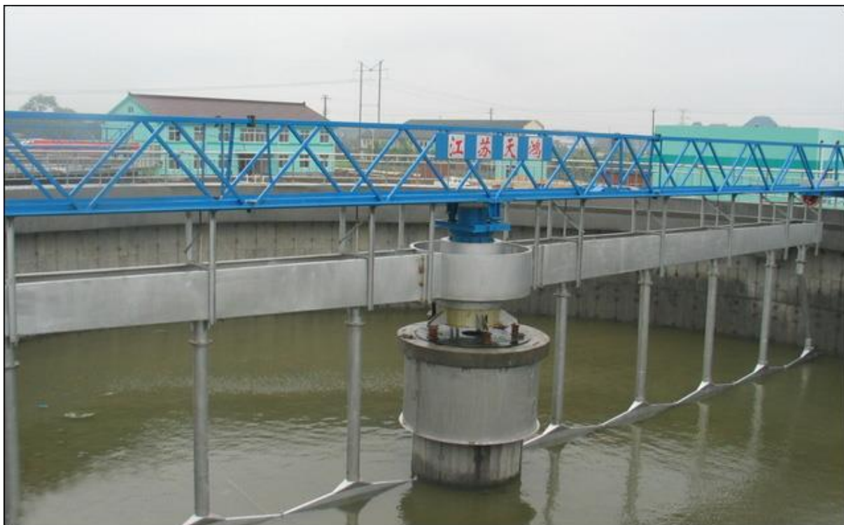
图 4.21 全桥式 ZBX-35 型吸泥机现场图
